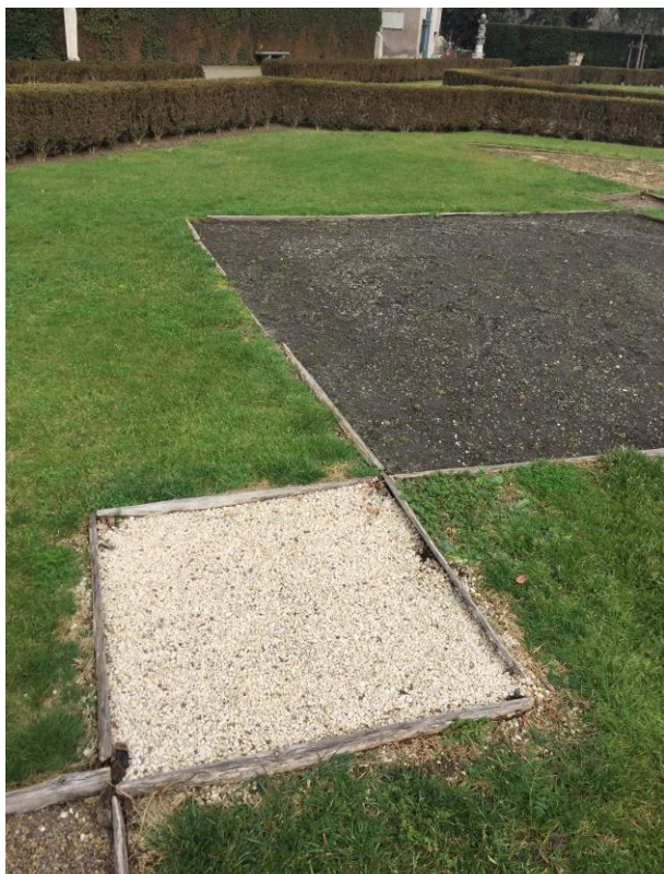
Image n. 10 : Bordure en bois (h : 7 cm environ) « flottantes » par manque de fixations par piquets, motifs géométriques avec remplissages de graviers blancs, de pyrolave rouge Photo novembre 2017. / Agence Pierre-Antoine Gatier
